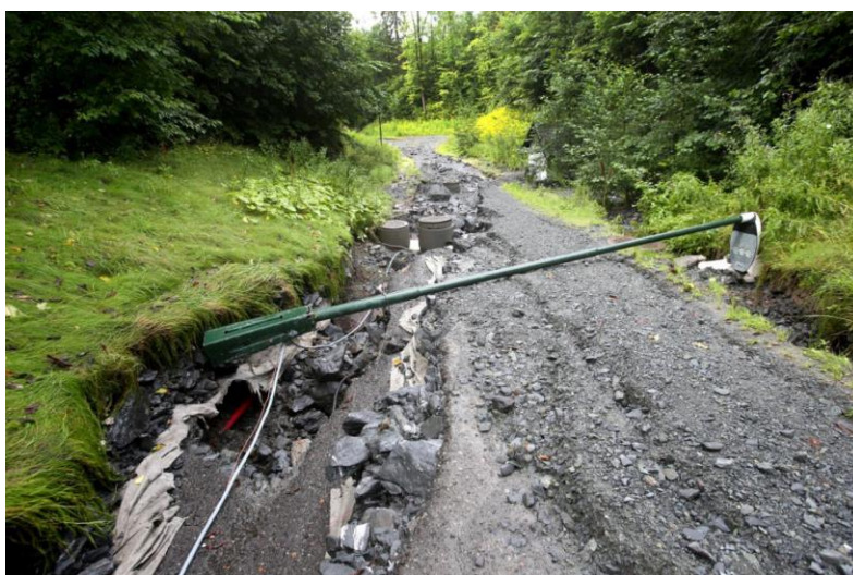
Figur 3 Erosjon nedstrøms gangkulvert under Kirkeveien 6.8.2016 (Kilde Budstikka)
