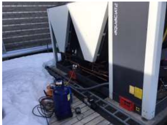
Figur 2: Utvendig luft til væske varmepumpe med luftinntak og varmepumpe plassert på tak
