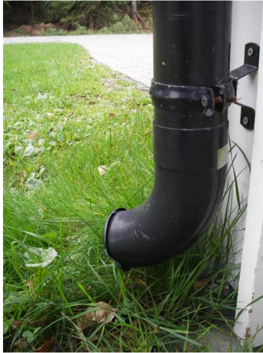
Frakoblede taknedløp kaster overvannet ut på plenen og reduserer tilførselen til avløpsnett (foto B.C. Braskerud)
