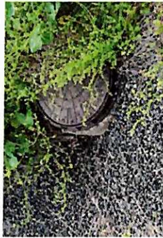
Det andre bildet er av en kum som ligger sentralt i området, nordest i det fete området som en gang har vært våtmark.
