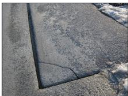
Uriktig utført asfaltskjøt uten fortanning
