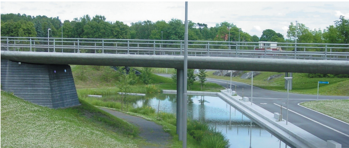
Figur 5-3: Eksempel på en sentral åpen dam for fordrøyning og rensing av overvann fra vei på Fornebu. Overvann fra en lengre veistrekning ledes til dammen (Foto: COWI).
